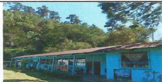
Foto 12: pared exterior que necesita sustitución de pintura
