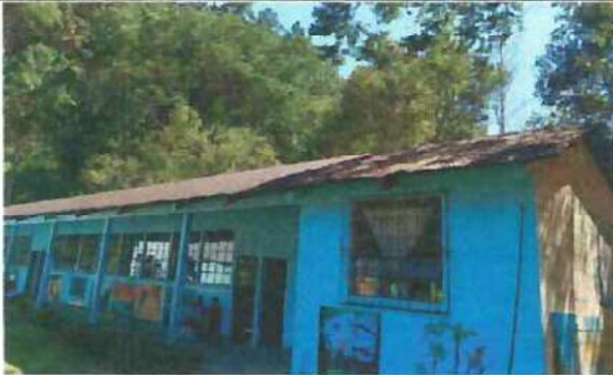
Foto 1: cubierta de lamina deteriorada que necesita ser cambiada
