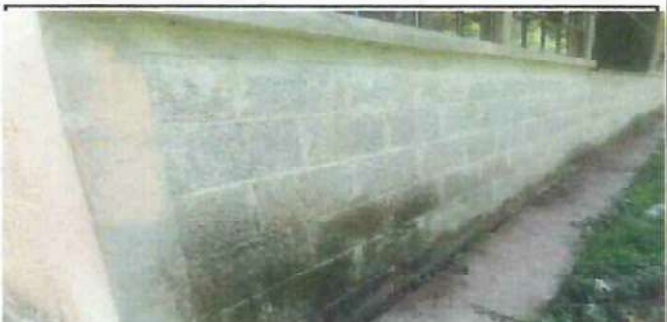
Foto 6: pared exterior a alisar por humedad
