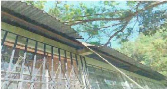
Foto 3: estructura portante a lijarse y pintar
