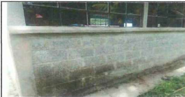
Foto 5: pared exterior parte trasera del establecimiento que necesita alisarse por humedad
