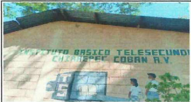
Foto 4: costaneras con oxidación que necesitan lijarse y pintar
