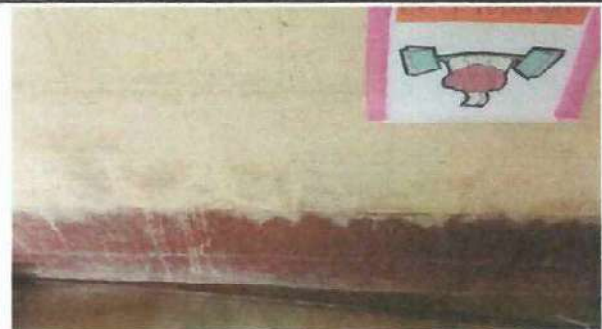
Foto 10: deterioro en paredes interiores que necesitan cernido y pintura
