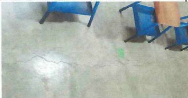
Foto 7: piso a sustituir por agrietamiento
