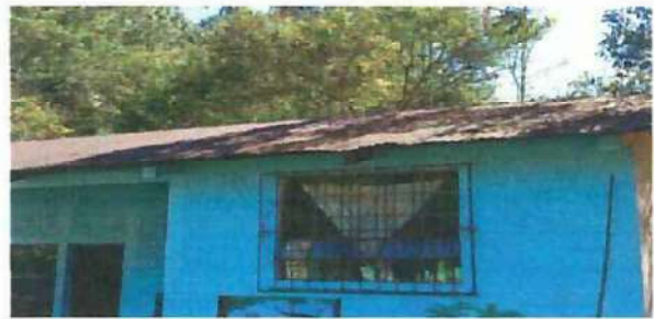
Foto 2: acercamiento de cubierta de lamina que necesita cambio
